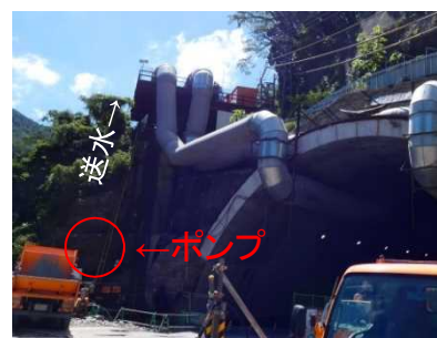
▲送水ポンプ設備
