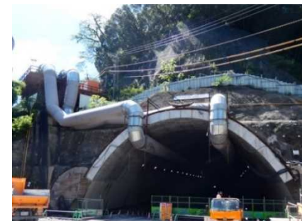
▲仮設備の事例(換気設備)
