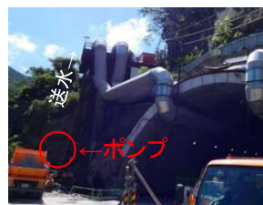
▲送水ポンプ設備
