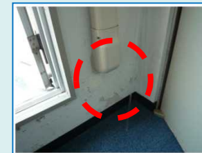
庁舎：各所外部より漏水跡が見られ内部建具も劣化が見られる。
