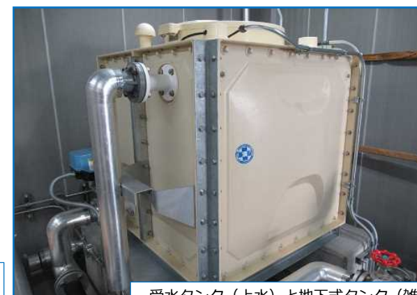
受水タンク（上水）と地下式タンク（雑用水）で4日分の災害時活動用水を確保
