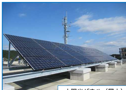
太陽光パネル（屋上）
