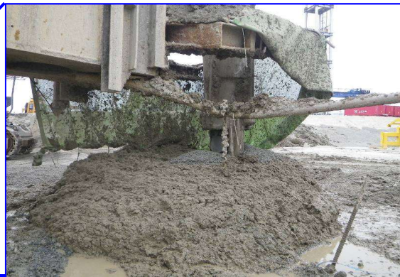
盛り上がり土の発生状況
