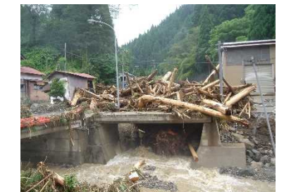
平成16年7月洪水(福井豪雨) 今立郡池田町千代谷の被害状況
