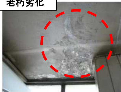
現業庁舎：室内への漏水による天井モルタルの剥離、破損。
