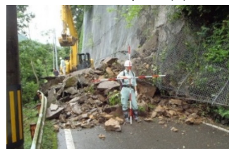
写真② 道路崩壊箇所(撮影時期:H24.6)
