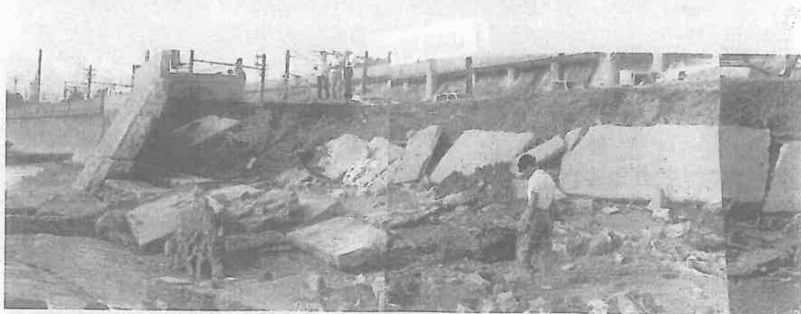
写真 3.3. 昭和39年台風20号による護岸の被災状況（舞子地先）
