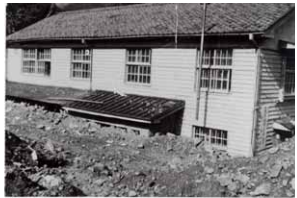
旧西谷村役場 (土石流被害)
