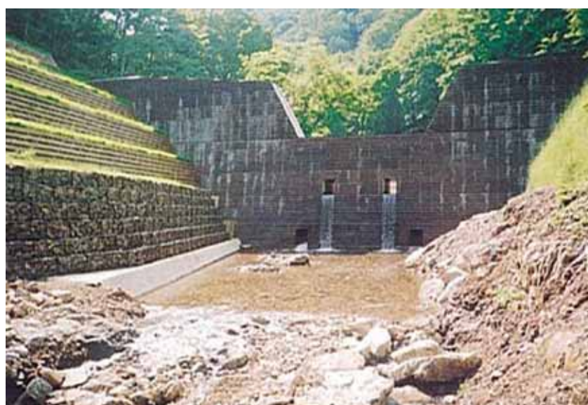
若谷えん堤 (間伐材を利用したウッドブロックを使用)
