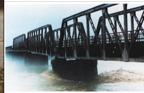
昭和56年7月洪水(梅雨前線) 高屋橋(県道福井三国線)の 橋脚が洗掘のため傾いた
