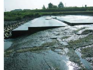
写真 9-2 魚類等の遡上・降下の阻害 (高木井堰)
