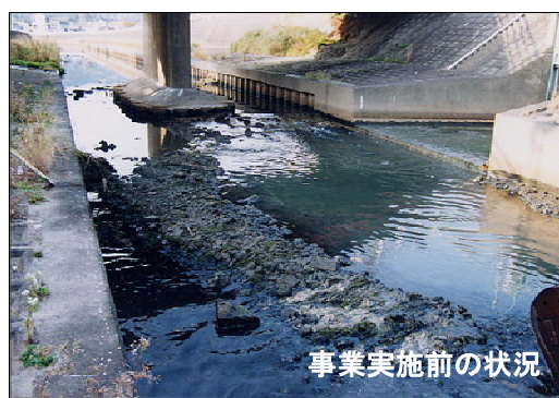
図 3.2 丸山橋のヘドロ堆積状況
