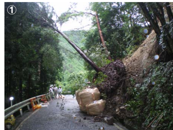
集中豪雨による法面崩壊状況 (H22.7.14撮影)
