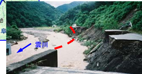
通行できなくなった国道157号(中島)
