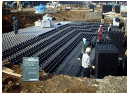
地下貯留式調整池
