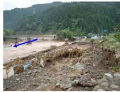
落橋した越美北線橋梁と被災した堤防の状況（福井市安波賀）
