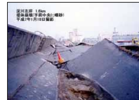
阪神・淡路大震災の被災状況(液状化)
