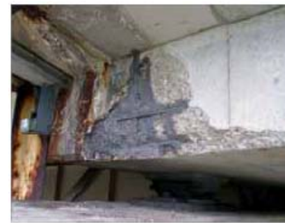
橋梁桁端部の損傷状況
