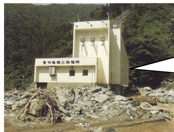
中島第二発電所土石流被害 (大雲谷川)
