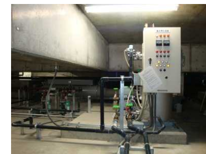
④水資源の有効活用のための特別な対策 (雨水利用設備)
