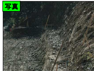
<法面崩落状況写真>
