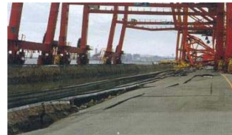
阪神・淡路大震災で被災した神戸港六甲アイランドRC-3
