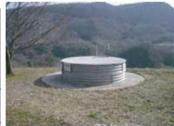
集水井地上部
