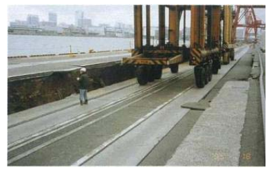
阪神・淡路大震災で被災した神戸港PI PC7-9
