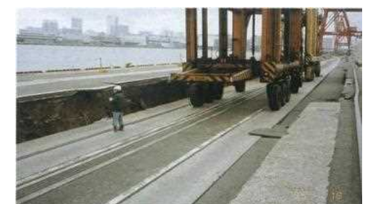
阪神・淡路大震災で被災した神戸港ポートアイランドPC7-9
