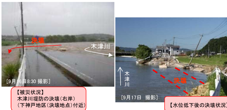
平成25年台風18号による洪水により木津川の堤防が決壊
