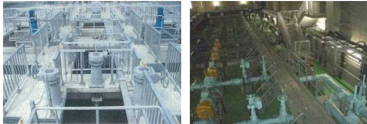
ゆめが丘浄水場(稼働中)
