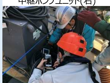
濁度測定状況
