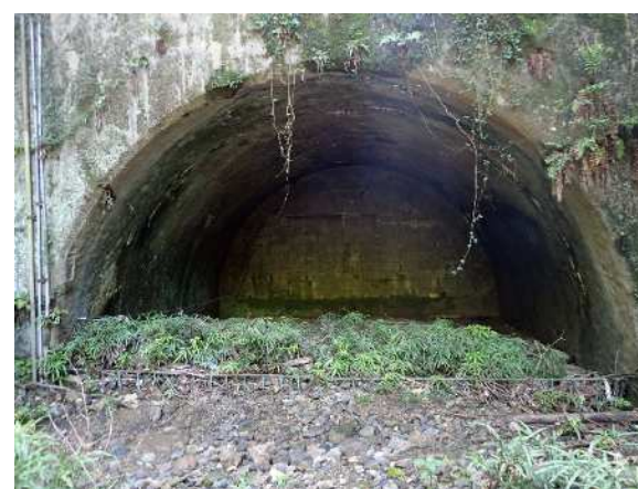
旧志津川導水路吐口部状況（土砂災害後）②
