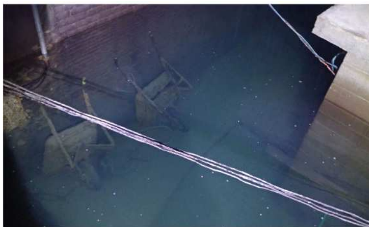
旧志津川導水路吐口 坑内浸水状況
