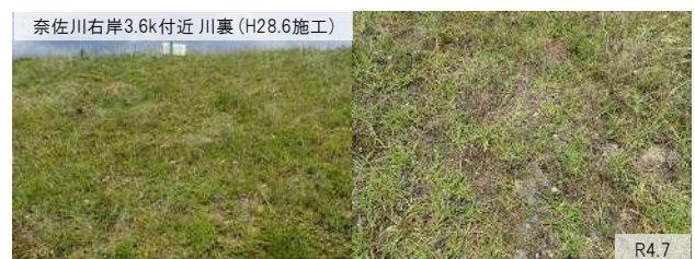
図-6 ティフブレア施工後7年経過した状態
