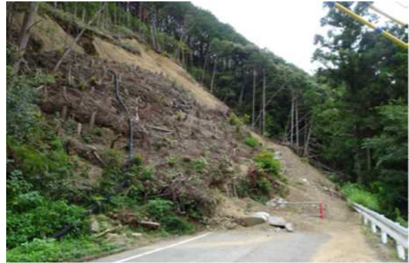
写真-3 災害現場
