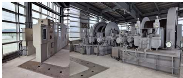
図-2 紀の川大堰ゲート機側操作盤と開閉装置
