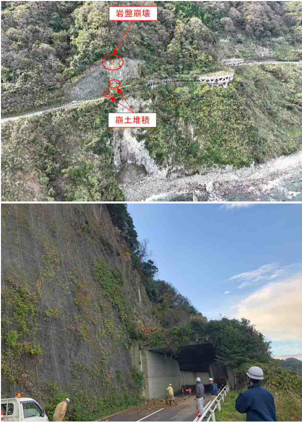
写-1 法面崩壊の状況
