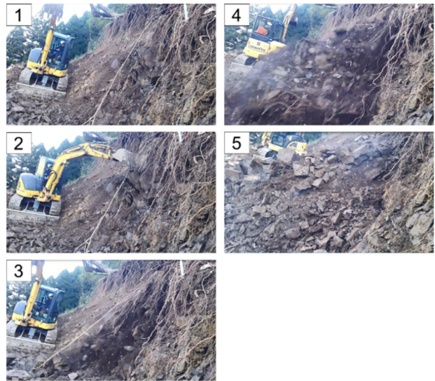
写真-3 地山崩落(コマ送り)(2023年11月撮影)
