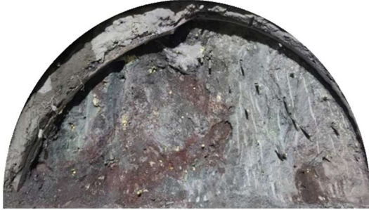
写真-1 自破碎状溶岩区間における支保工の変状と切羽状況 (TD2,887m)
