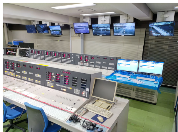
写真-3 新旧操作卓併設時
