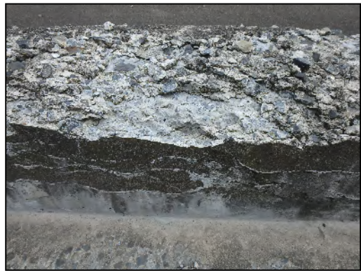
図9 宮田でのスケーリング拡大状況写真
