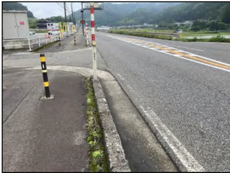
図5 大糠でのスケーリング発生状況
