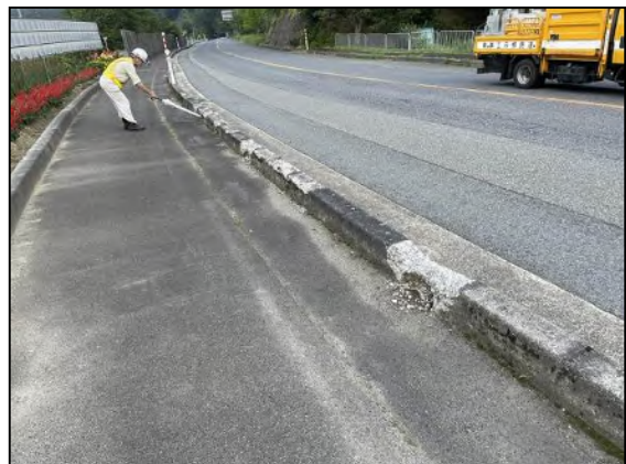
図-3 八井谷でのスケーリング発生状況
