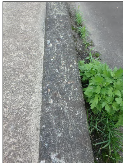
図-13 進展期のスケーリングによる劣化状況
