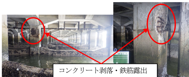
写真-2 脚柱部老朽化状況
