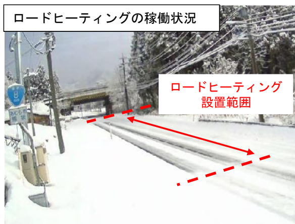
図-7 ロードヒーティングの稼働状況
