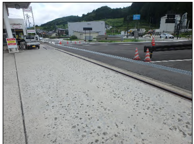
図10 黒田でのポップアウト発生状況
