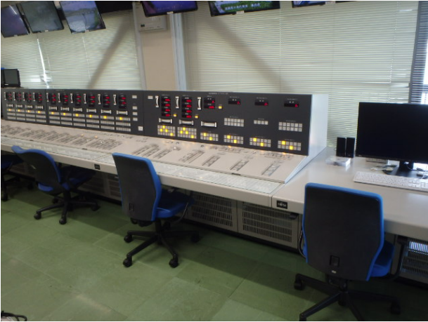
写真-2 堰操作卓
