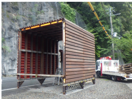
写真12. 車両防護のためのプロテクター
