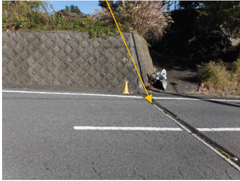
(現道部1:横断側溝及び舗装面ひび割れの状況)
