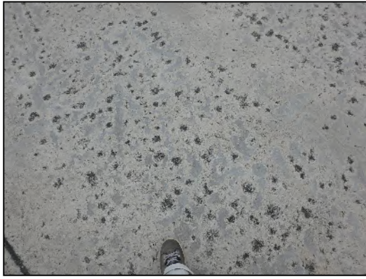
図-11 黒田でのポップアウト発生状況
