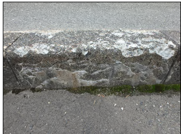
図-14 加速期から劣化期のスケーリングによる劣化状況
