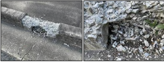
図4 八井谷でのスケーリング拡大状況写真
