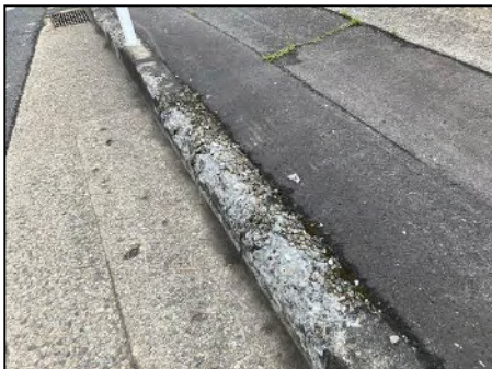
図6 大糠でのスケーリング拡大状況写真
