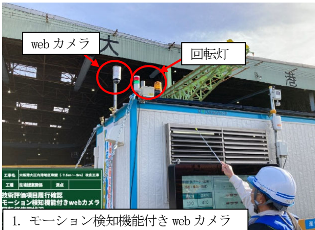
写真-6 モーション検知機能付きwebカメラ設置状況
