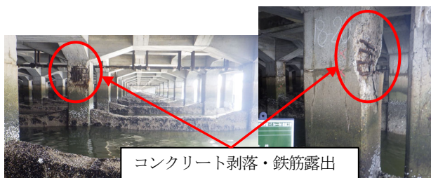
写真-2 脚柱部老朽化状況
