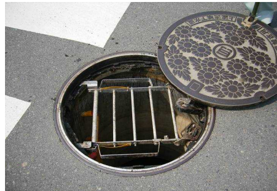
図-2 幹線マンホール
