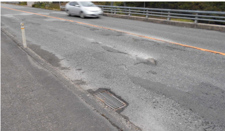
写-2 令和4年度の路面損傷状況
