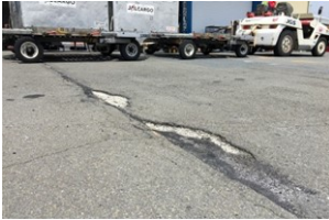
(c) アスファルト舗装の剥がれ
