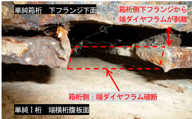
写真-2 単純箱桁端ダイヤフラム破断箇所（下方より撮影）
