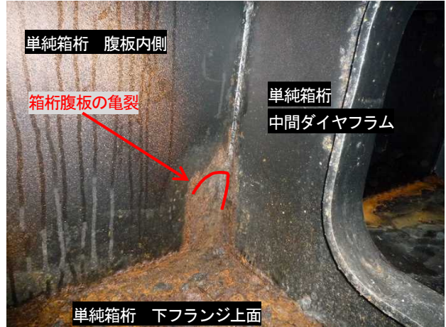
写真-3 新たに確認された単純箱桁腹板の亀裂
