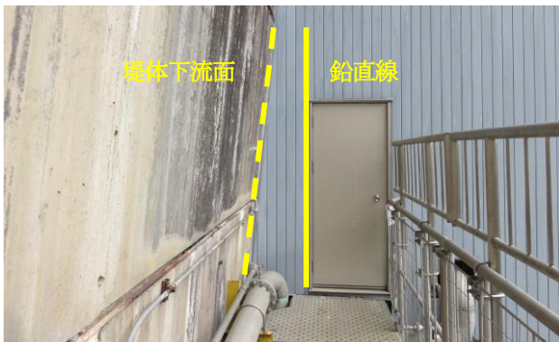
図3 ダム堤体の傾斜
