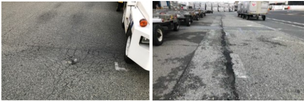
(a) 亀甲クラック
