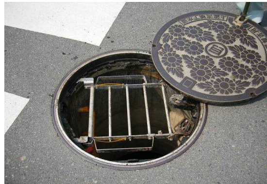
図-2 幹線マンホール
