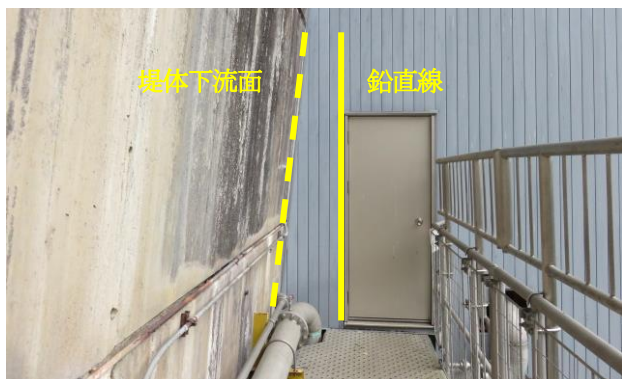
図3 ダム堤体の傾斜
