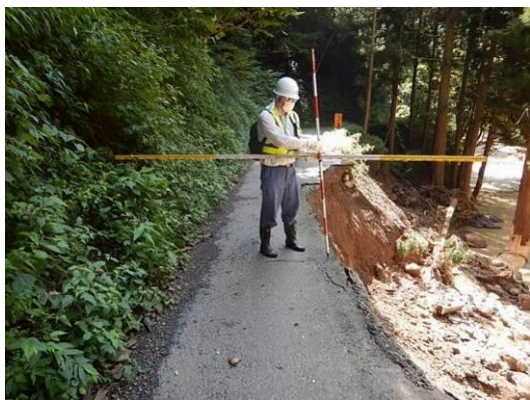
写真5 県道中河内木之本線における豪雨による被災状況 った。
