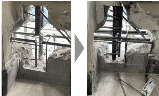
図-13 配管貫通のため切断された鉄筋の補修
