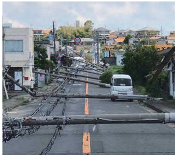
図-1 台風による電柱の倒壊
