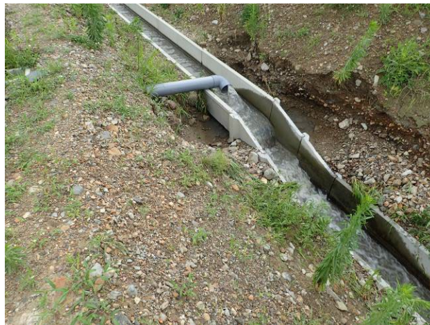
図-8 階段落差工法面侵食状況
