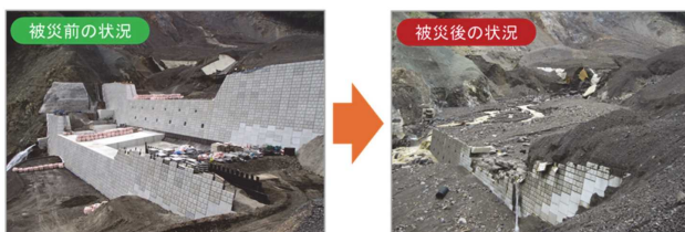
図-8 出水による施工中の堰堤の被災状況
