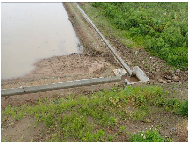
図-6 土砂流入状況
