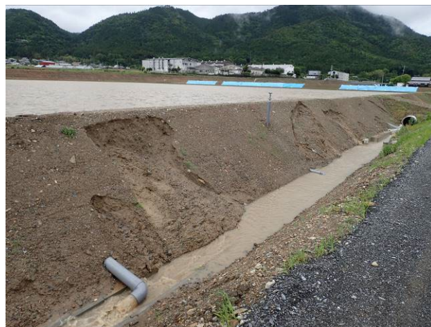
図-2 法面崩壊状況
