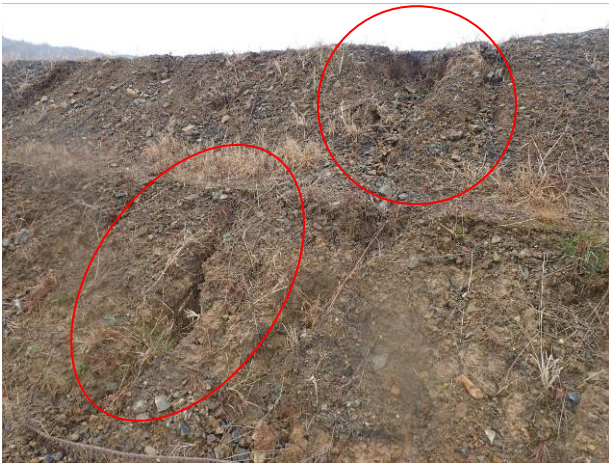
図-10 道路法面侵食状況
