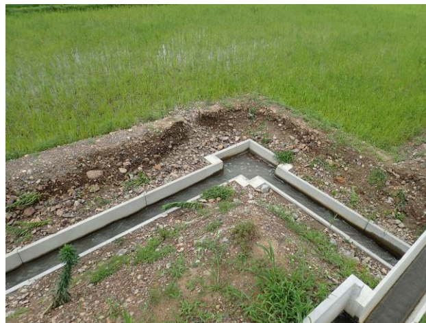
図-9 屈曲部法面侵食状況
