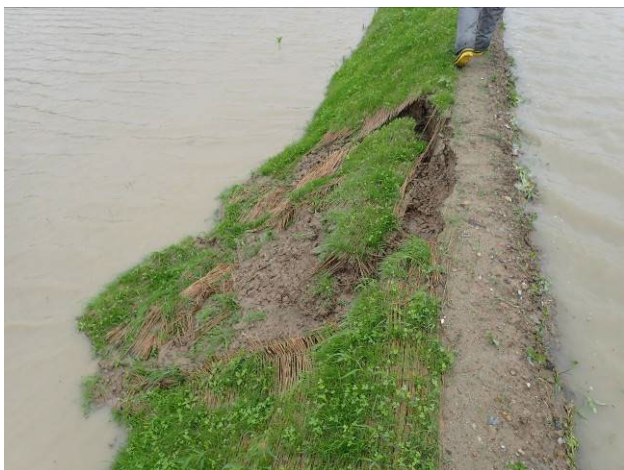
図-5 ほ場法面崩壊状況
