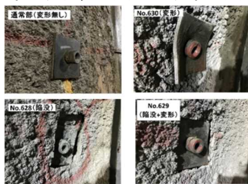
写真4-1 ロックボルト変状写真
