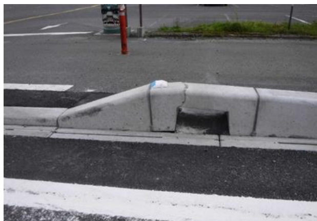
写真-1 縁石(水抜き穴付き)破損状況
